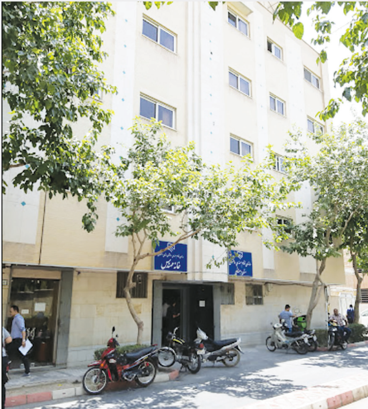
ساختمان نظام مهندسی اصفهان سالانه با ۱۰ سانتیمتر نشست مواجه است. ساختمان‌ها در شهرک کاوه نیز برخی آسیب‌های جدی دیده‌اند.
